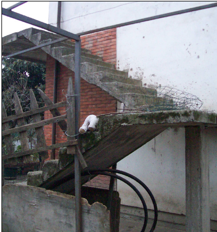
Foto 7: Scala esterna in c.a.
