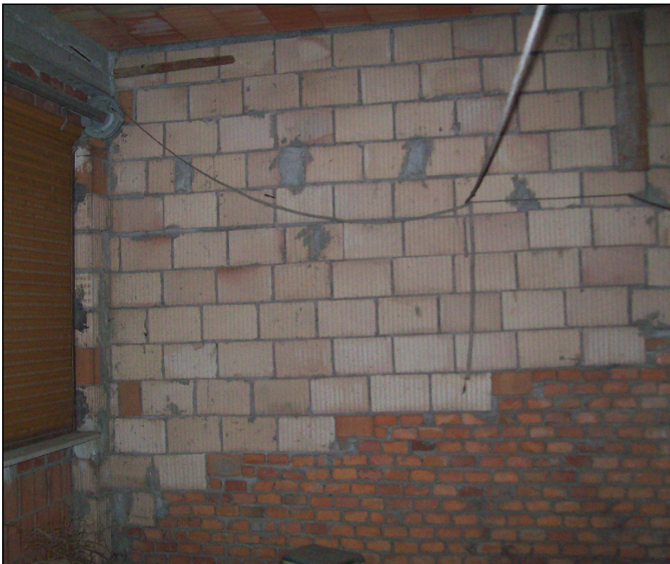
Foto 12: discontinuità della muratura a seguito dell'intervento di sopraelevazione
